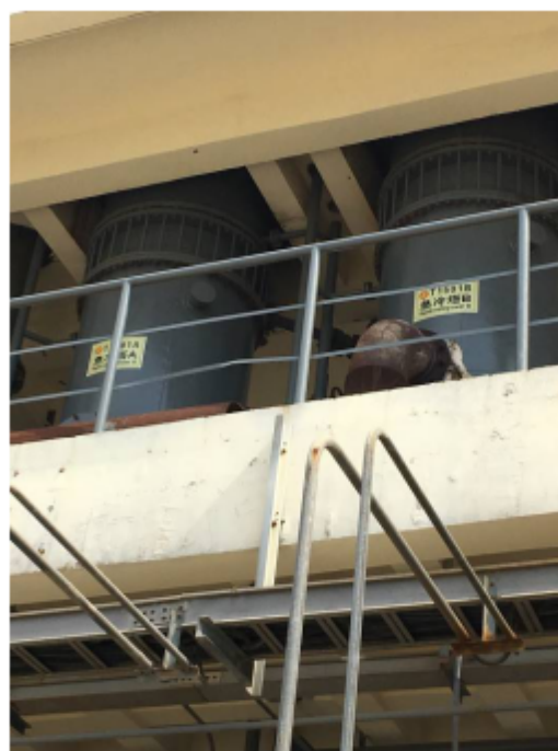
急冷塔（塔长10m）
